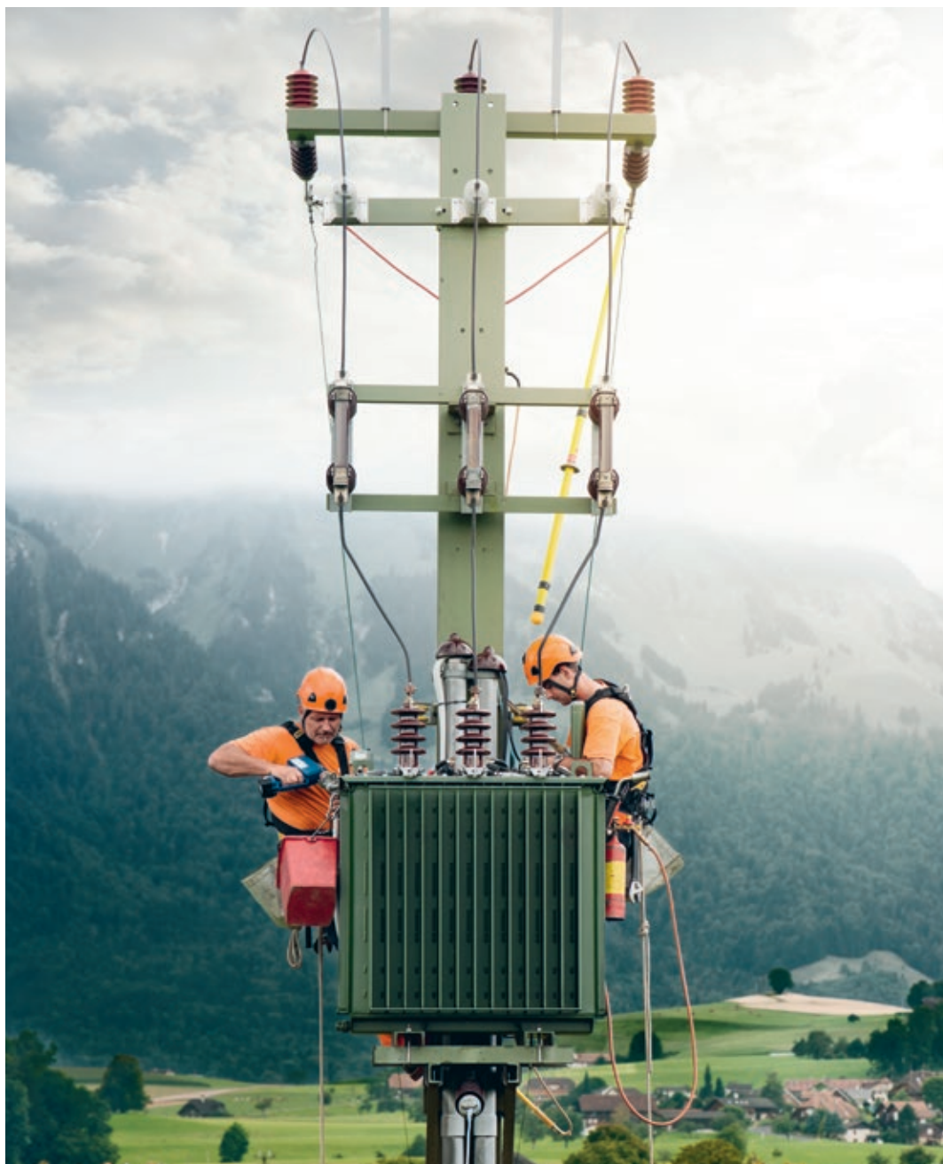
Grâce aux technologies intelligentes, les transformateurs de distribution tels que celui représenté ci-contre peuvent réguler les différences de tension directement sur le réseau.
